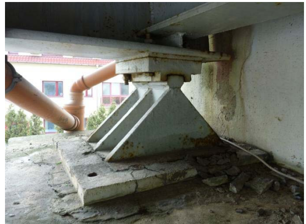
Spękane ciosy podłożyskowe oraz korozja wżerowa łożyska stałego
