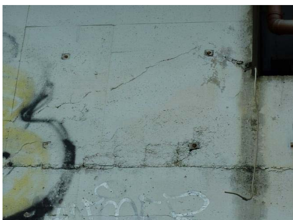
Uszkodzenie powierzchniowe i spękania na powierzchni skrzydła przyczółka od strony stacji Okęcie widok od strony Piaseczna
