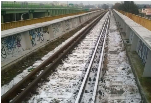
Zanieczyszczona podsypka tłuczniowa
