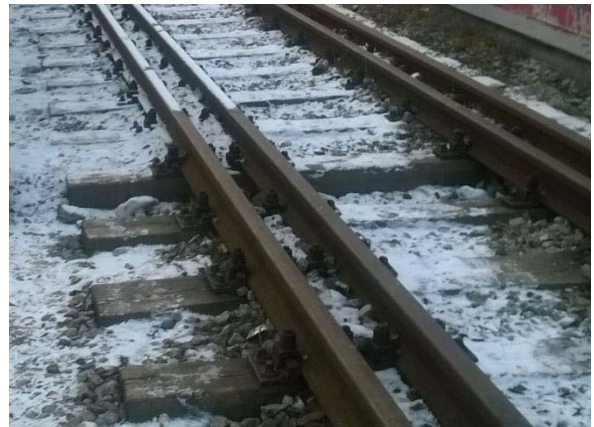
Uszkodzone podkłady kolejowe
