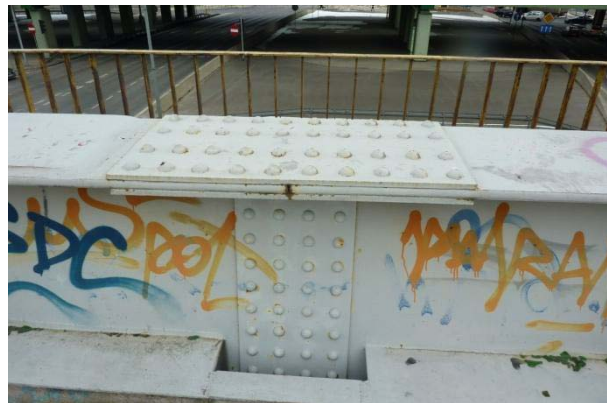
Korozja szczelinowa i korozja w obrębie nitów
