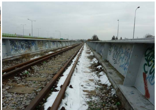
Uszkodzone podkłady betonowe i zanieczyszczona podsypka tłuczniowa
