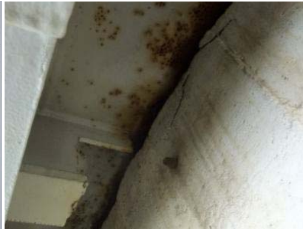
Górna krawędź ścianki żwirowej, widoczne zarysowania na powierzchni betonowej
