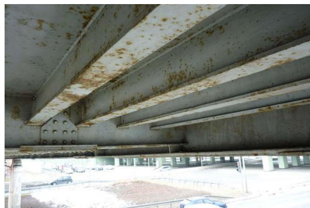
Korozja powierzchniowa i punktowa na elementach przęsa, widok od spodu konstrukcji
