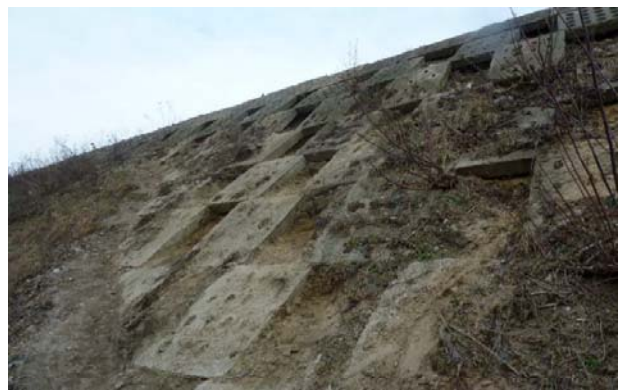
Zabezpieczenie skarpy za pomocą luźno osadzonych ażurowych płyt betonowych od strony stacji Okęcie
