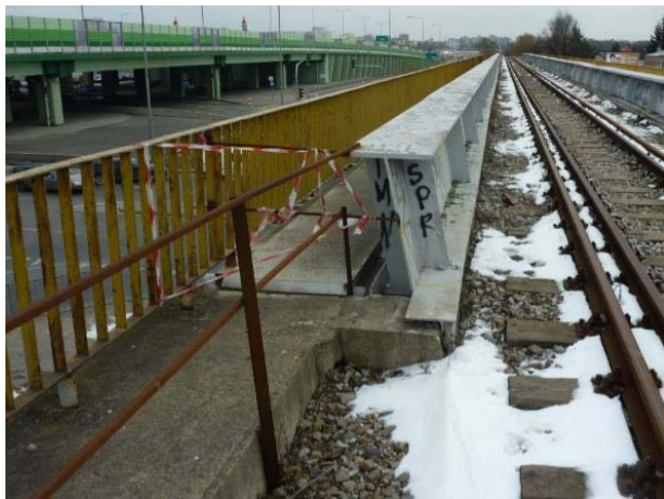
Zabezpieczenie wejścia na chodnik służbowy za pomocą prowizorycznej balustrady stalowej oraz taśmy ostrzegawczej
