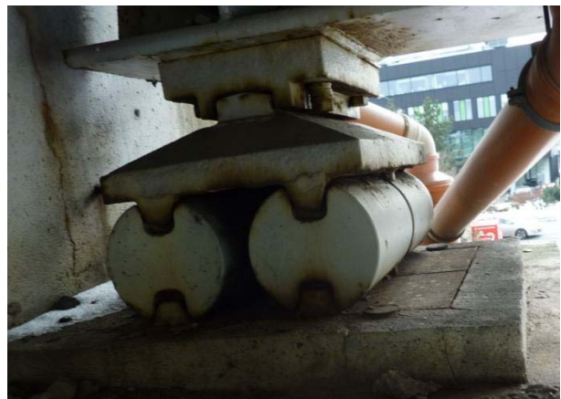
Łożyska ruchome na przyczółku od strony stacji Kabaty
