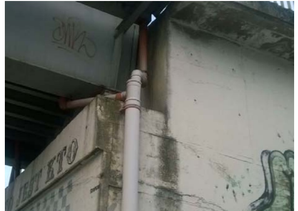
Uszkodzona rura spustowa przy przyczółku od strony Lotniska
