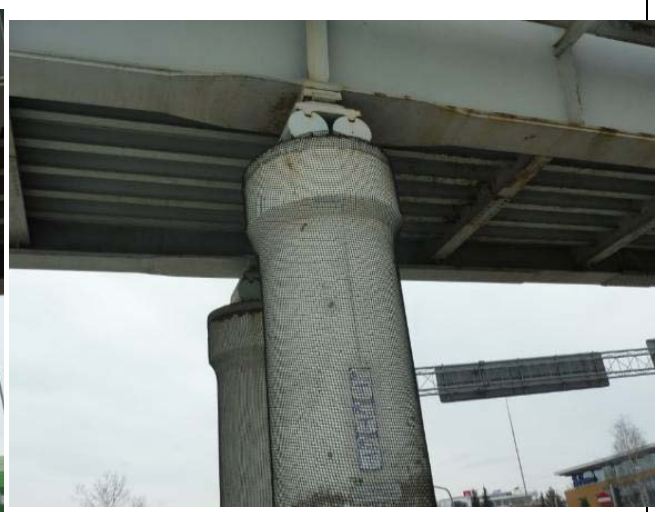
Uszkodzenie powłok ochronnych żelbetowych podpór pośrednich
