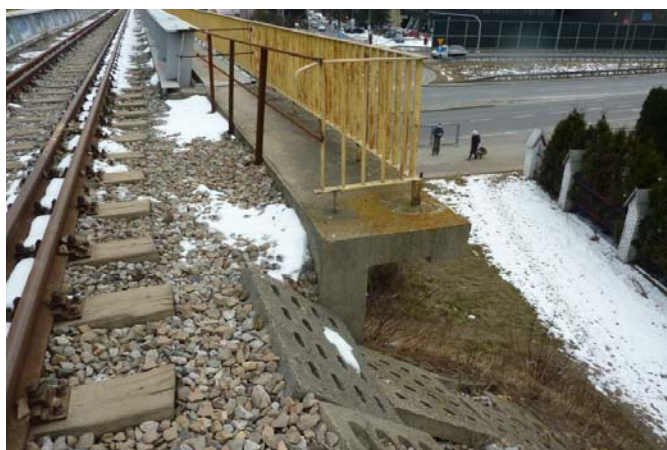
Zbyt krótkie skrzydło przyczółka, obsypywanie się tłucznia nawierzchni kolejowej, luźno osadzone płyty od strony stacji Okęcie
