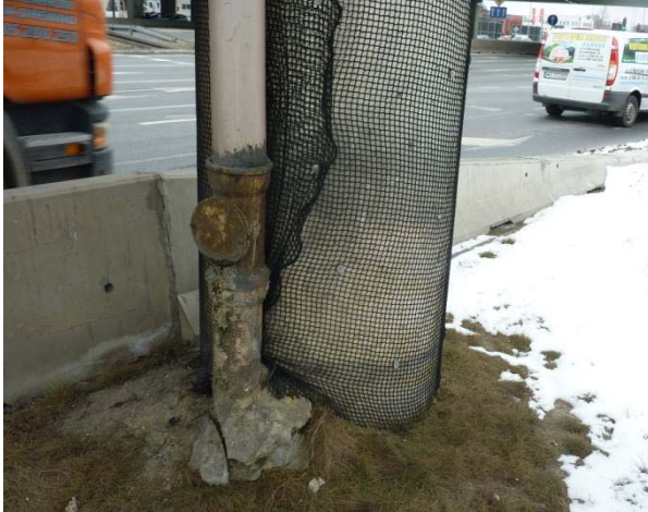
Uszkodzona rura spustowa przy podporze pośredniej skrajnej od strony stacji Kabaty
