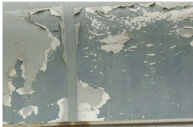
Zawansowana korozja powierzchniowa oraz odspojenia powłoki antykorozyjnej na środniku dźwigara głównego widok z boku od strony Piaseczna
