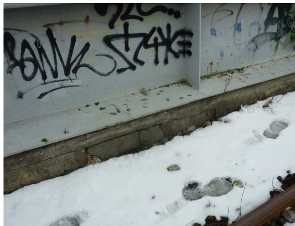
Widoczne zarysowania, spękania powierzchni płytek betonowych
