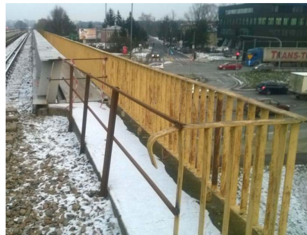
Zabezpieczenie wejścia na chodnik służbowy za pomocą prowizorycznej balustrady stalowej oraz taśmy ostrzegawczej
