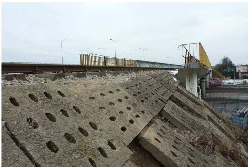
Widoczne ubytki w tłuczniu na dojazdach, spowodowane wieloletnim obsypywaniem się tłucznia nawierzchni kolejowej, luźno osadzone płyty betonowe- skarpa od strony stacji Okęcie
