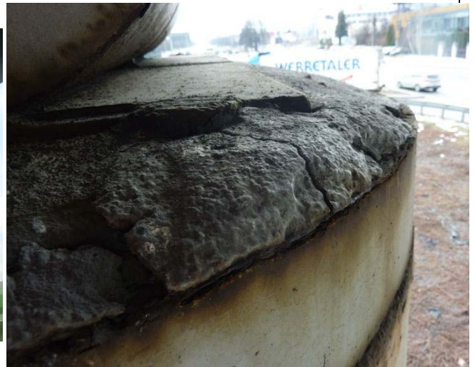
Spękane nadlewki zwiężczające podpór pośrednich, zabrudzenia odchodami ptaków
