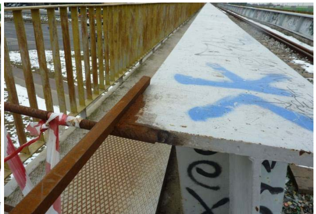
Korozja szczelinowa na styku prowizorycznej balustrady z prętów stalowych i półki górnej dźwigara głównego
