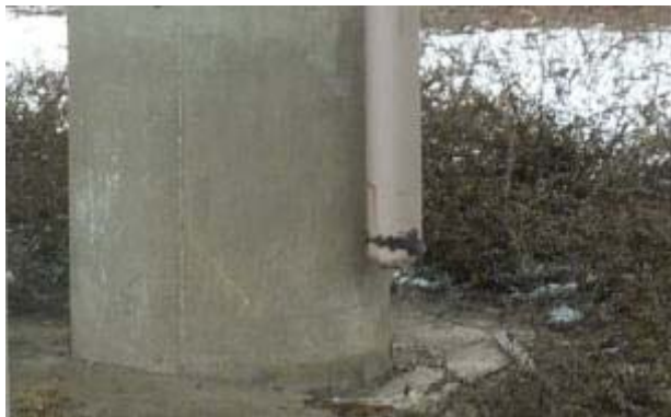
Uszkodzona rura spustowa na podporze pośredniej wewnętrznej
