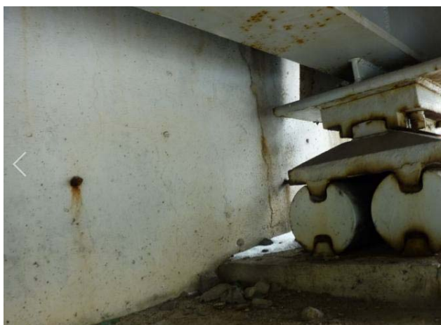
Rysy na ścianie żwirowej za łożyskiem, widoczne uszkodzenia powłoki antykorozyjnej łożyska
