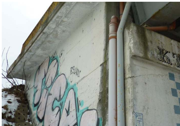
Zanieczyszczenia i przebarwienia na ściankach przyczółka, widoczne zarysowania poziome i ukośne, uszkodzenia powłoki malarskiej oraz deformacja płyt ażurowych betonowych umacniających skarpeę za przyczółkiem
