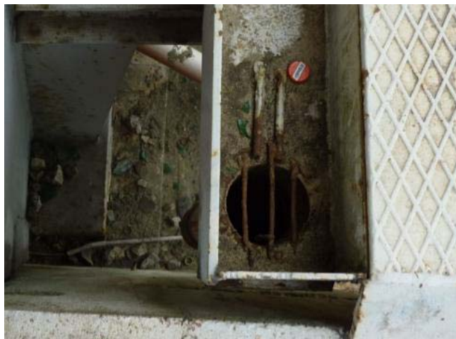
Zanieczyszczenie przy wpusście , prowizoryczne zabezpieczenie wpustu za pomocą prętów stalowych
