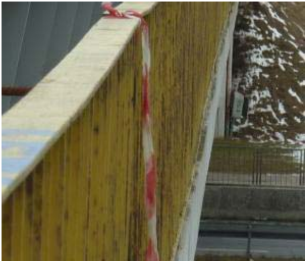
Uszkodzona powłoka malarska balustrady
