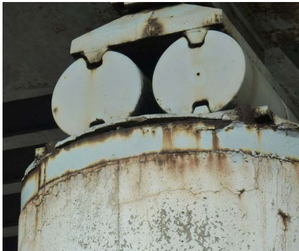
Korozja elementów stalowych łożyska, uszkodzenia opaski stalowej i spękana powierzchnia betonowa w górnej części podpory
