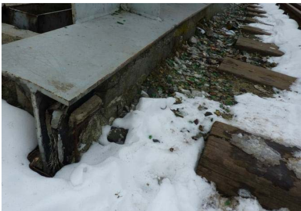
Uszkodzenia bitumicznej izolacji koryta balastowego, oraz płytek betonowych, widoczne zarysowania, spękania powierzchni betonu, uszkodzone podkłady betonowe oraz zanieczyszczona podsypka tłuczniowa
