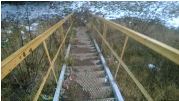
Korozja powierzchniowa na elementach stalowych schodów skarpowych
