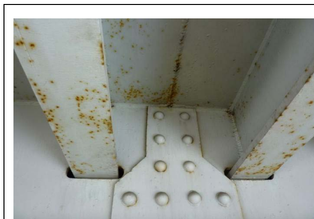
Korozja punktowa na elementach pomostu
