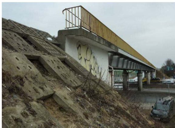
Luźno osadzone płyty betonowe na skarpie za przyczółkiem od strony stacji Kabaty
