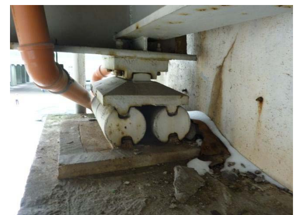
Wykruszenia betonu zalegające na niszy podłożyskowej, widoczne uszkodzenia powłoki antykorozyjnej łożyska
