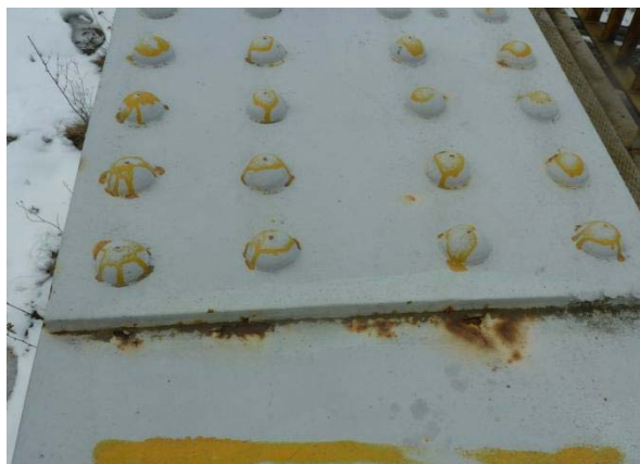
Korozja szczelinowa i korozja w obrębie nitów
