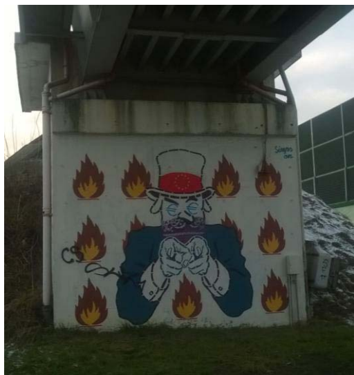
Przyczółek od strony stacji Okęcie- widoczne zacieki na oczepe ścianki czołowej przyczółka
