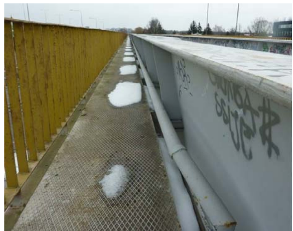
Chodnik służbowy o szer. 75 cm oraz nieprzepisowej wysokości balustrady 90 cm
