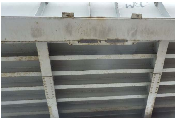
Korozja elementów stalowych i uszkodzenia powłoki antykorozyjnej od spodu przęsła
