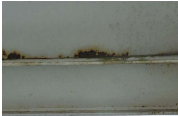
Zaawansowana korozja szczelinowa i wżerowa
