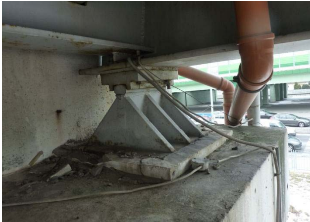
Elementy uziemienia konstrukcji wiaduktu
