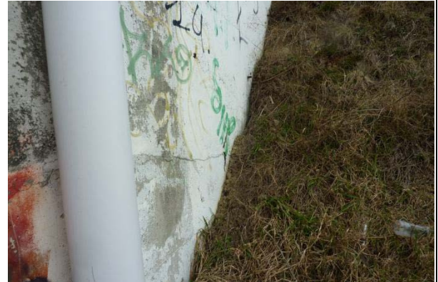
Widoczne zarysowania ukośne na skrzydłach przyczółka
