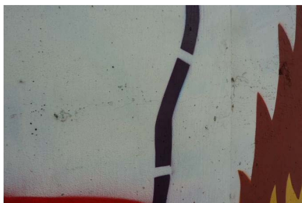
Zarysowania poziome na ścianie przyczółka
