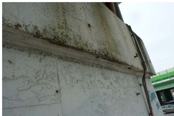
Uszkodzona powierzchnia betonowa ścianki czołowej przyczółka, widoczne zarysowania ukośne i poziome
