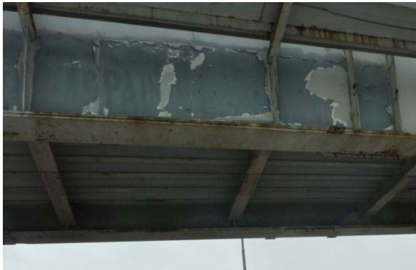
Zawansowana korozja powierzchniowa oraz odspojenia powłoki antykorozyjnej na środniku dźwigara głównego widok z boku od strony Piaseczna
