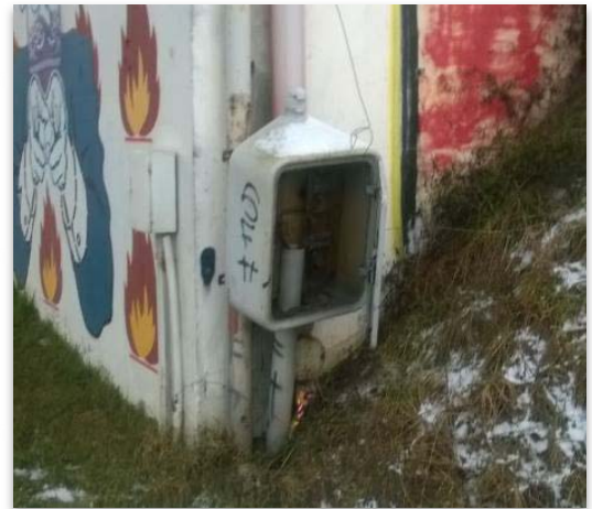
Urządzenia obce przy przyczółku od strony Lotniska
