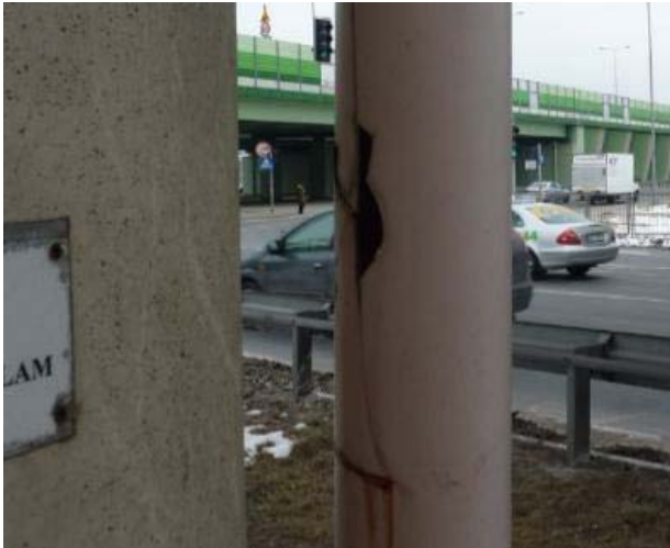
Uszkodzona rura spustowa przy podporze pośredniej
