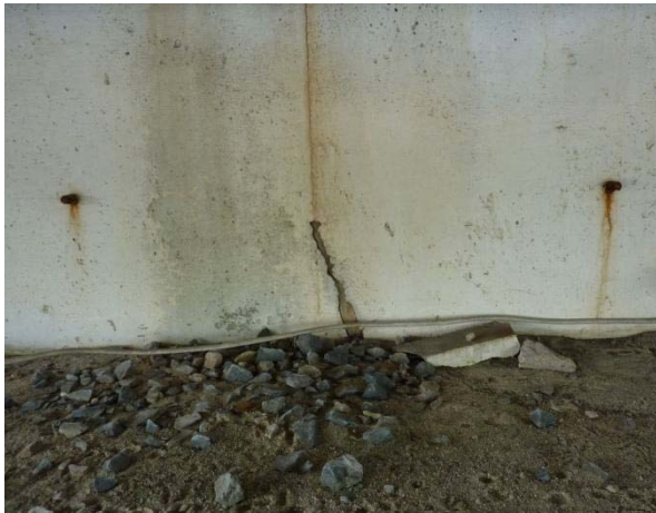
Rysa na ścianie żwirowej między łóżyskami
