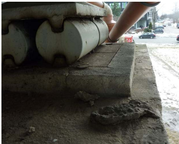
Uszkodzenia ciosu podłożyskowego oraz korozja i uszkodzenia powłoki antykorozyjnej na łożysku
