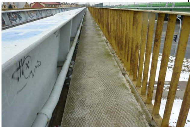
Chodnik służbowy o szer. 75 cm oraz nieprzepisowej wysokości balustrady 90 cm
