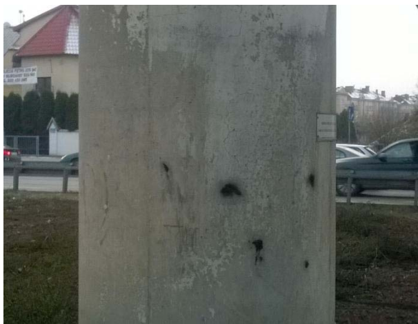
Uszkodzenie powłok ochronnych żelbetowych podpór pośrednich wewnętrznych, widoczne zarysowania pionowe oraz ukośne na podporach pośrednich
